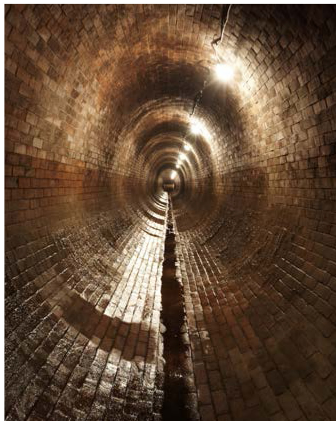
Inspección de un sistema de desagüe de aguas residuales para la canalización segura de aguas
