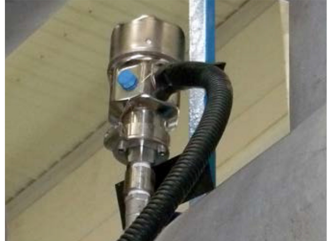
Medición confiable de la presión en un sistema de membrana
